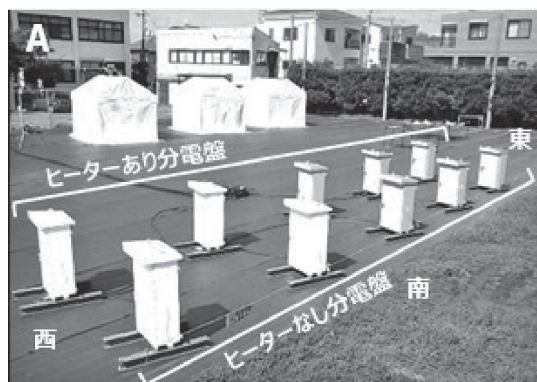
図-4 COOL 分電盤の実証実験
